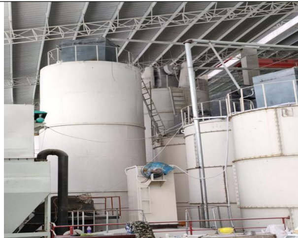
储罐及废气处理设施
